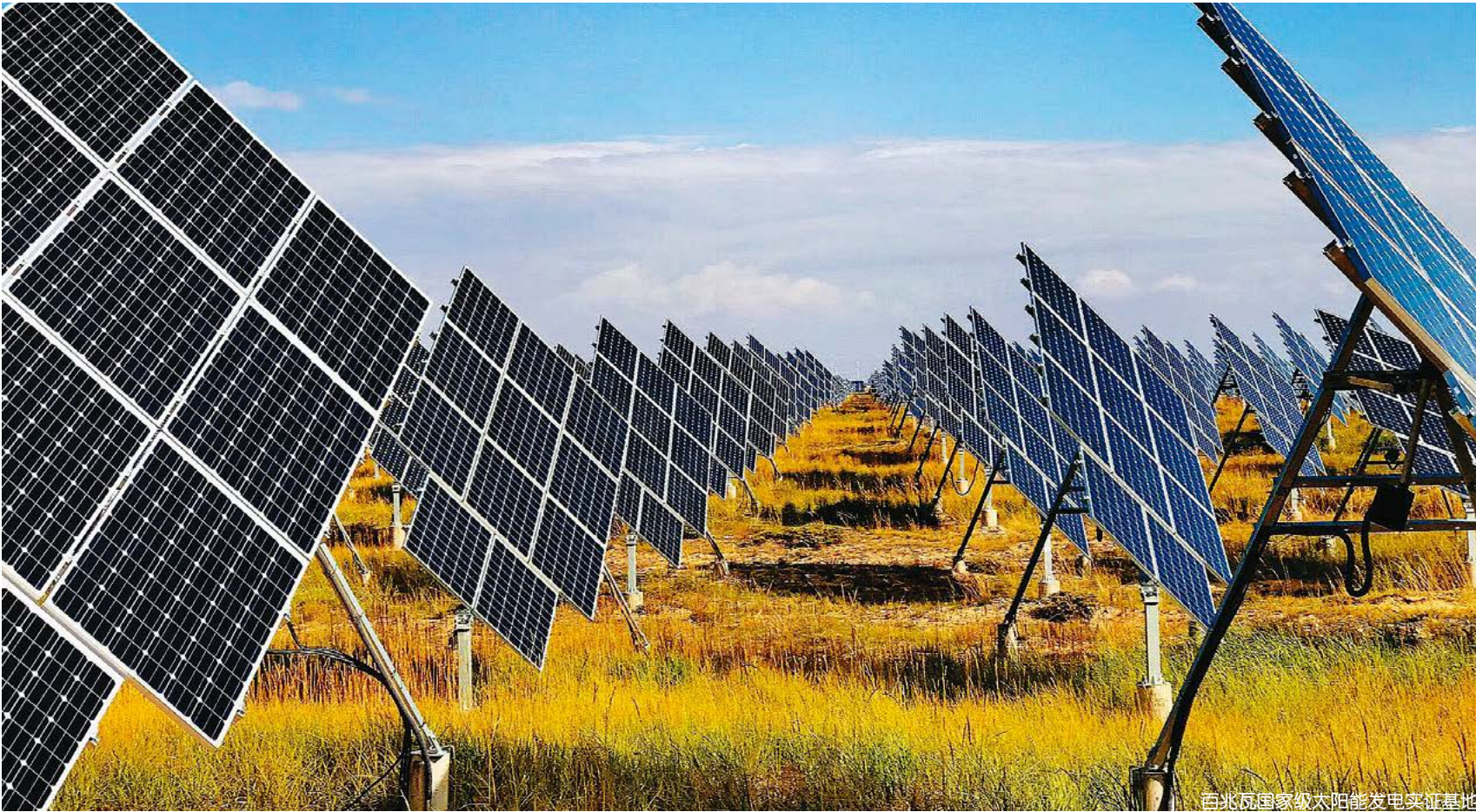
百兆瓦国家级太阳能发电实证基地
